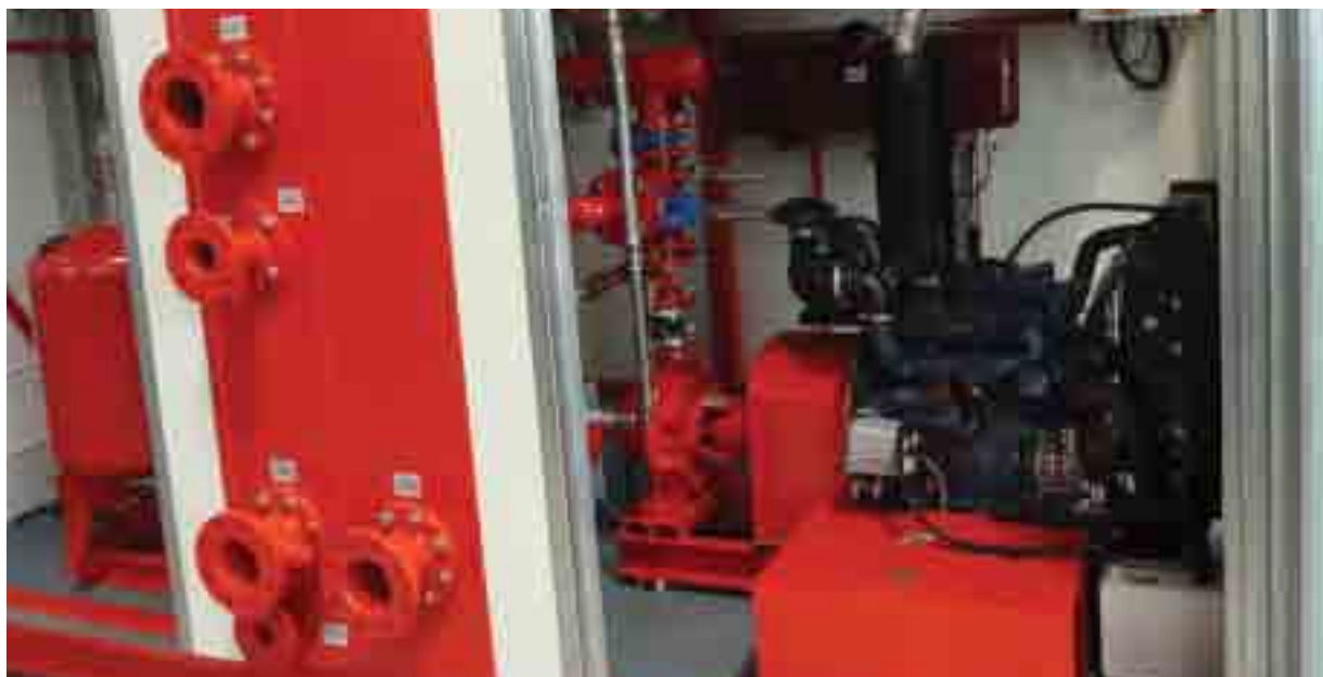
CABINE EXTÉRIEURE AUX RÈGLES UNI 11292/2008 POUR PLACEMENT DE GROUPES CONTRE LES INCENDIES.
